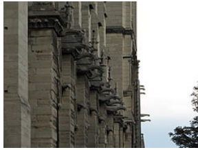
Cette série de longues gargouilles de la façade sud de la nef draine les toitures des chapelles latérales.
